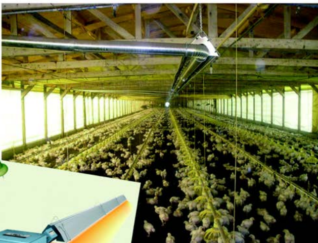
Calefacción por TUBOS RADIANTES para pollos parrilleros
